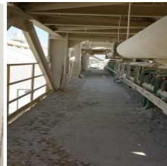
Pasillo correa 702/ Planta de Cal/ 2 Personas
