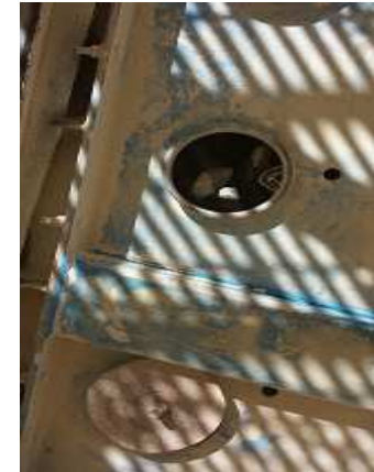
Condicion Sub Estandar , Harnero 451 sin tapa en costado erecho por el cual se produce derrame
